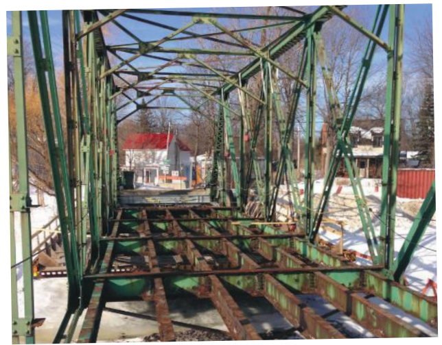
Le pont du ruisseau St-Jean qui relie Léry et Châteauguay est dans un très mauvais état depuis plusieurs années. L'automne dernier le Ministère des Transports du Québec est intervenu pour débiter les réparations nécessaires. L'hiver a mis un arrêt temporaire aux réparations qui ont maintenant recommencé. Le tout devrait être terminé pour le début du mois de juillet 2015.
